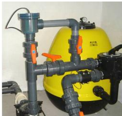
Instalación en "bypass"
